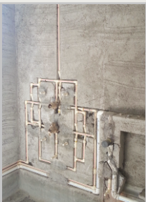
ACTUAL PLUMBING PHOTO
